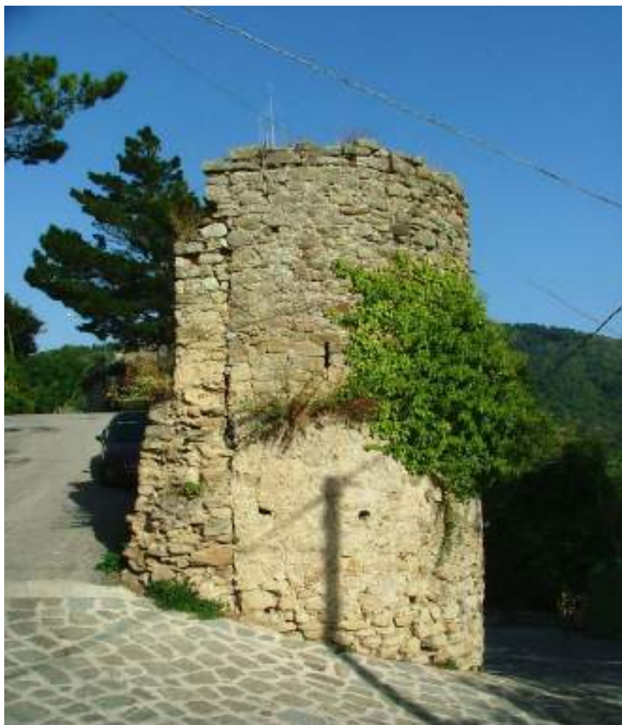
1. Torre 9, lato W, è visibile parte della cortina muraria cui si addossa la torre.
