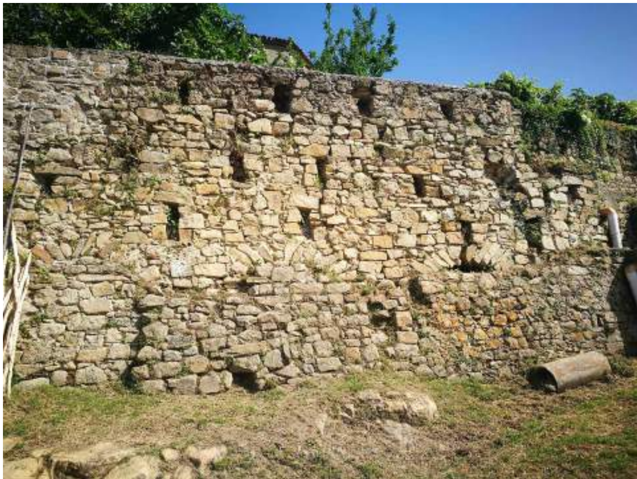
1. Cortina muraria tra la torre 6 ed avancorpo murario n.7, particolare delle aperture a sezione rettangolare per lo scolo delle acque, vista da SW
