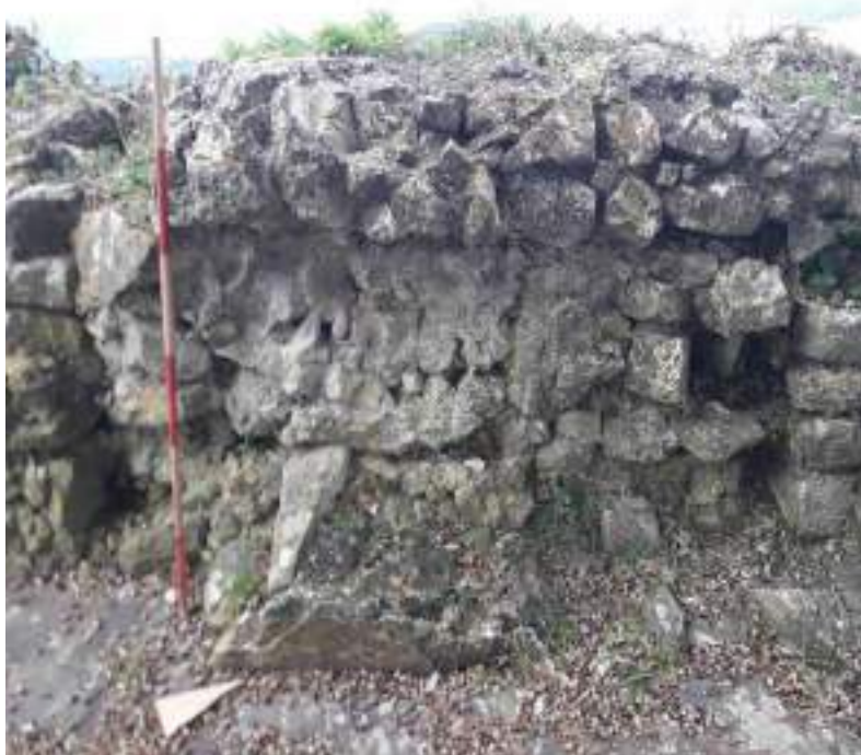
10. Mastio, recinto esterno. Particolare del crollo del paramento murario
