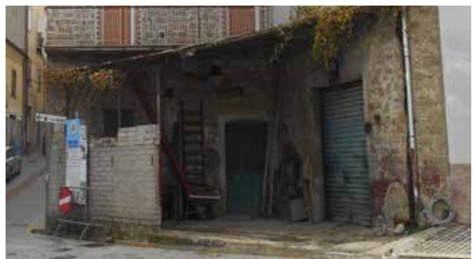
Gioi. Dettaglio tettoia in via Conti. ESEMPIO NEGATIVO.
