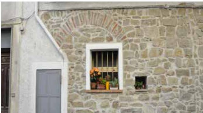
Gioi. Edificio in via Roma. Finitura facciata: ESEMPIO POSITIVO. Pluviale non lineare e superfetazioni. ESEMPIO NEGATIVO.
