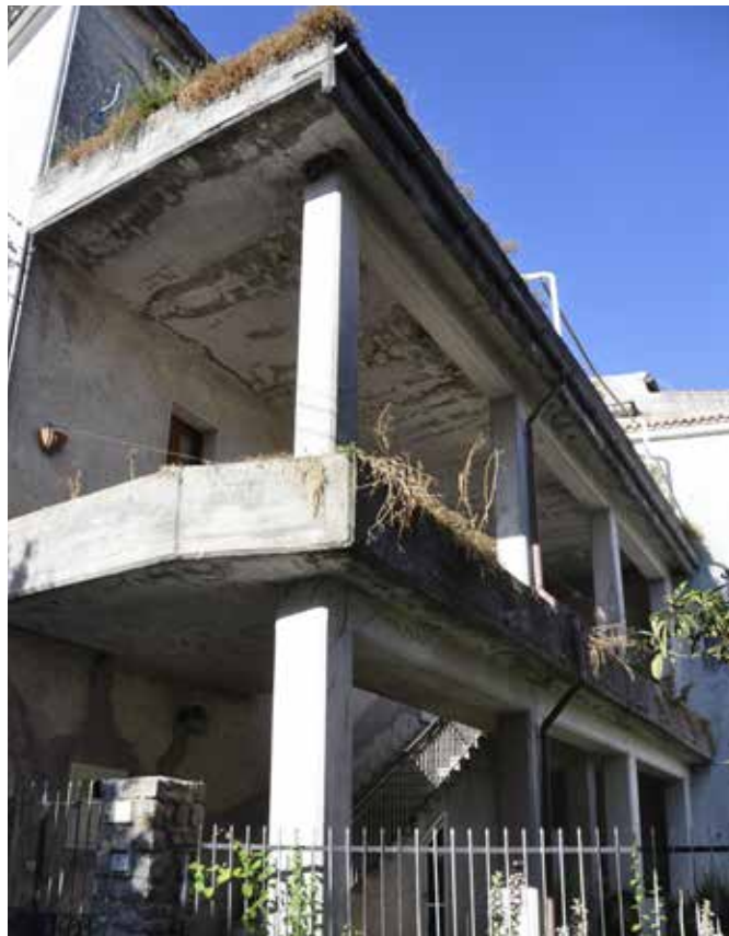
Gioi. Edificio in via Garibaldi. ESEMPIO NEGATIVO.
