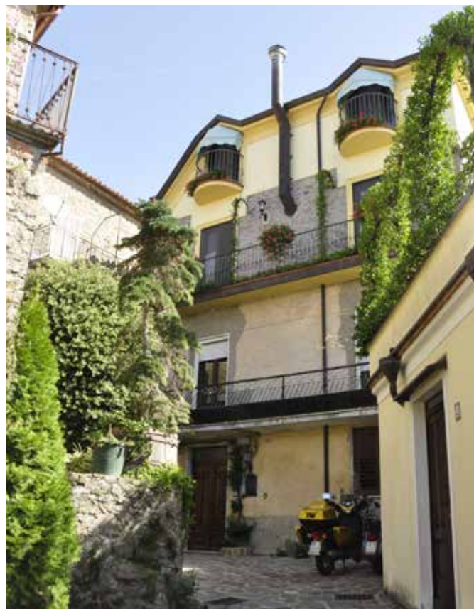
Gioi. Edificio via Risorgimento. ESEMPIO NEGATIVO.
