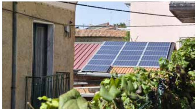
Gioi. Copertura edificio in via S. Francesco. ESEMPIO NEGATIVO.
